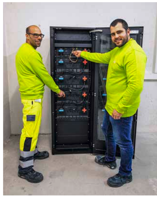
Michael Lang und Patrick Friedrich (v.l.) haben den Batteriespeicher im Griff.
