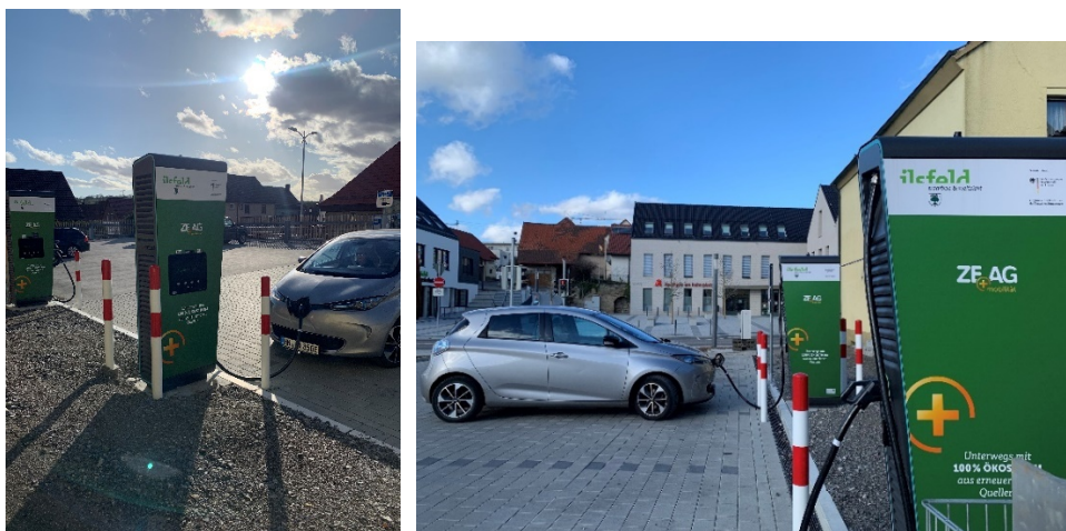
Zwei der drei neuen Kombicharger in der Ilsfelder „Neuen Mitte“
